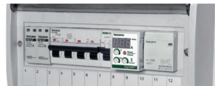
Ejemplo-3. VIGIWATT junto a protector de sobretensión permanente y transitoria.
